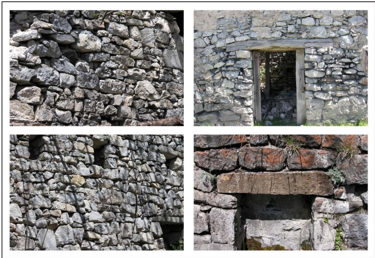
Fig. 15 : La pierre dans les constructions. À Barels, c'est essentiellement le calcaire qui prédomine, cependant de nombreux blocs schistés se délitent et se fragilisent sous l'effet des cycles gel/dégel.
