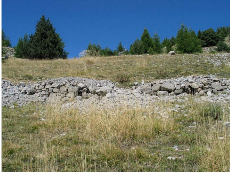
Fig.5. Un mur de terrasse perd sa blocaille.
